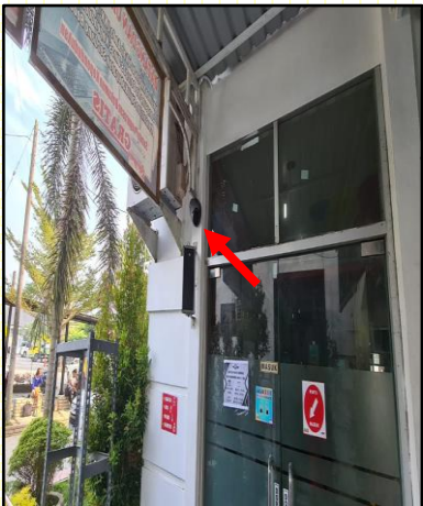
CCTV Luar Kantor
