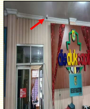
CCTV Dalam Kantor
